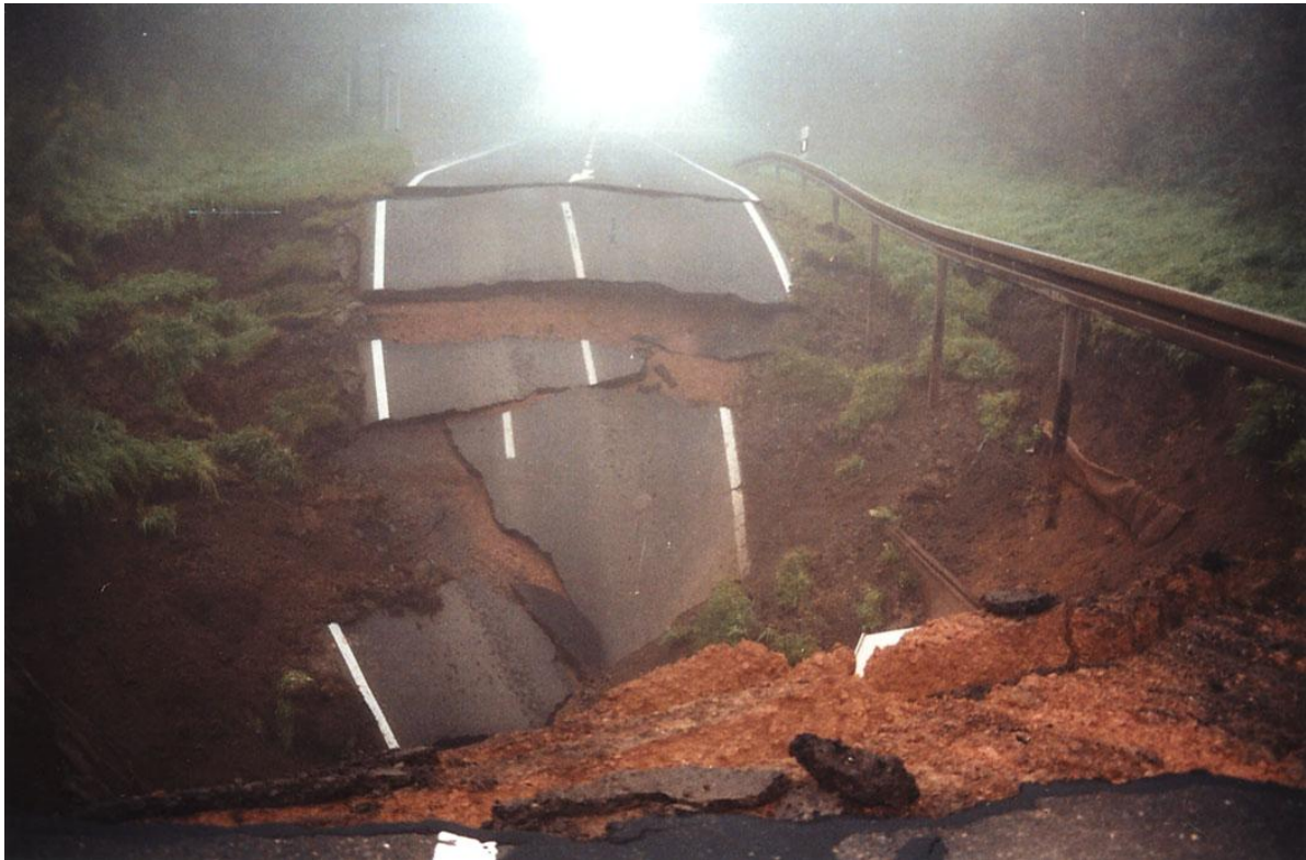
Abb. 9: Nachbruch des Erdfalles auf der B 180 im Oktober 2001 mit vollständiger Zerstörung der Fahrbahn (Foto: DAUTERSTEDT)
